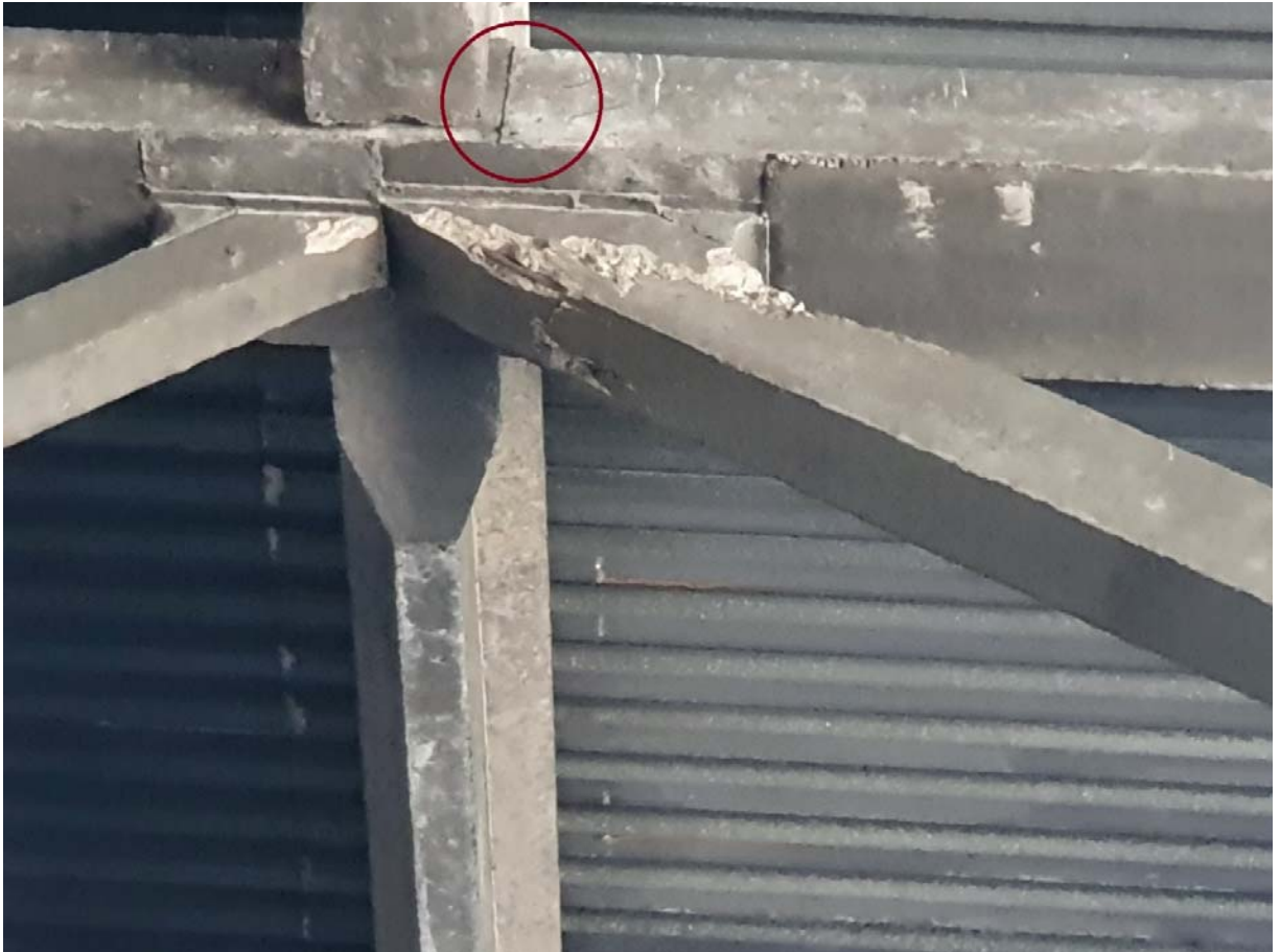
Fotografija 9: Rešetka u osovini 10 – oštećenje dijagonale
