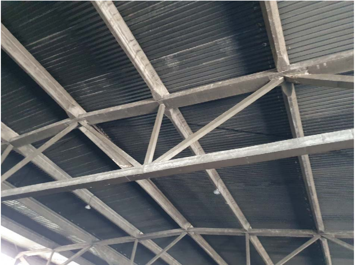
Fotografija 4: Rešetka u osovini 10 – oštećenje dijagonale
