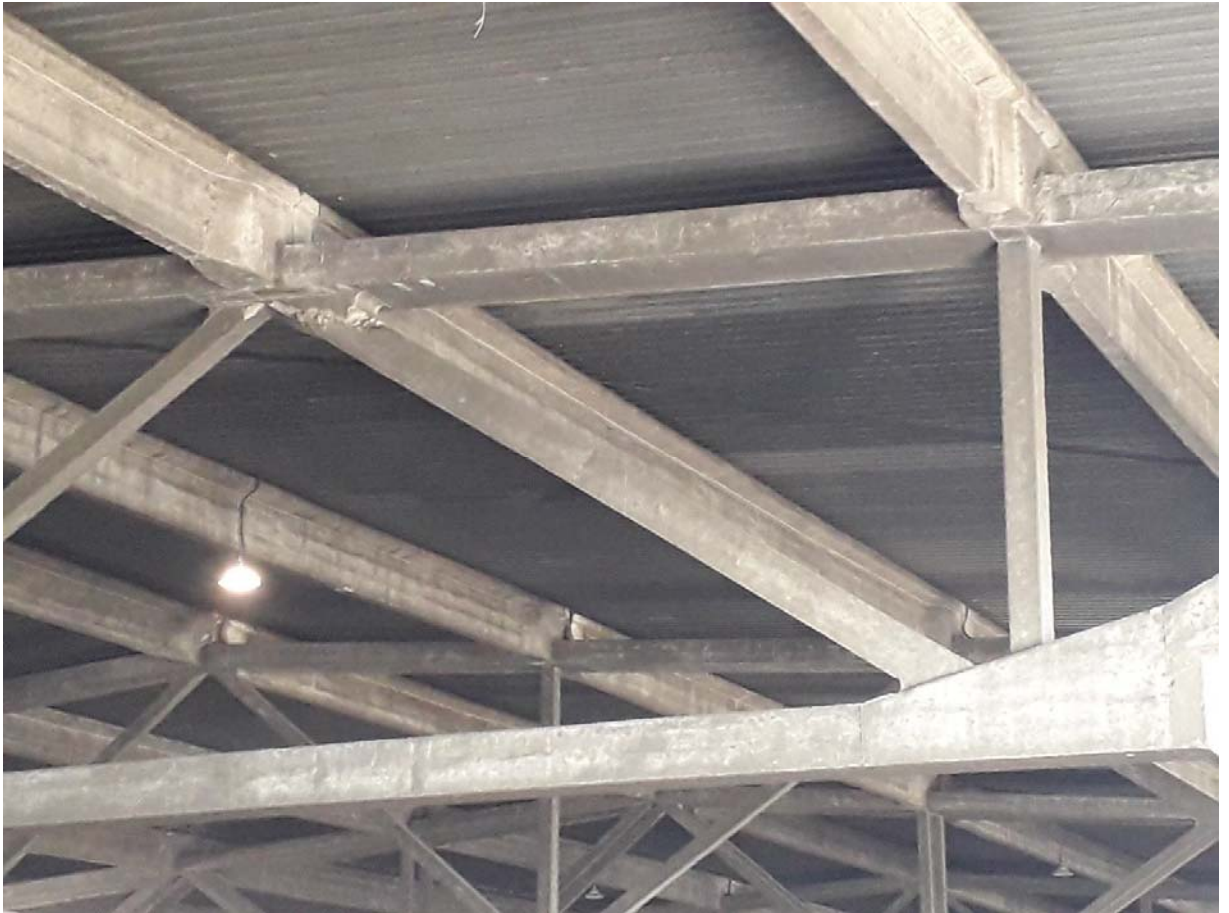
Fotografija 6: Rešetka u osovini 10 – oštećenje dijagonale
