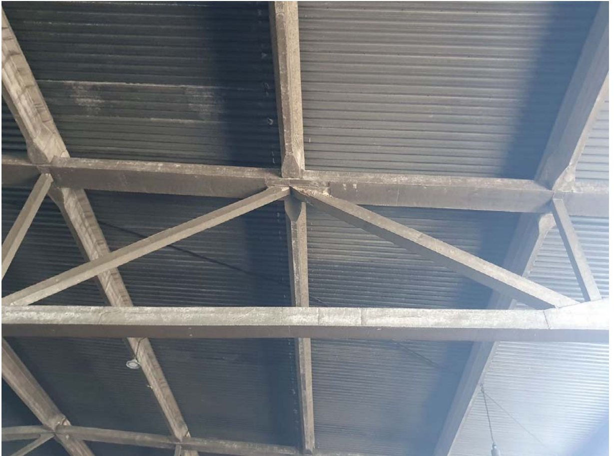
Fotografija 8: Rešetka u osovini 10 – oštećenje dijagonale
