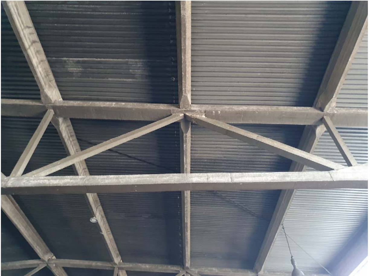
Fotografija 3: Rešetka u osovini 10 – oštećenje dijagonale
