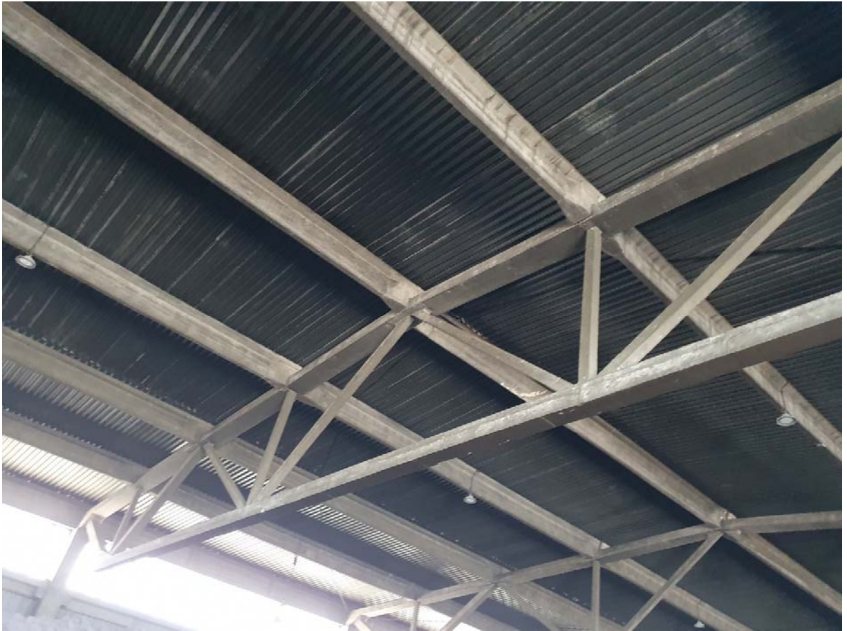
Fotografija 2: Rešetka u osovini 10 – oštećenje dijagonale
