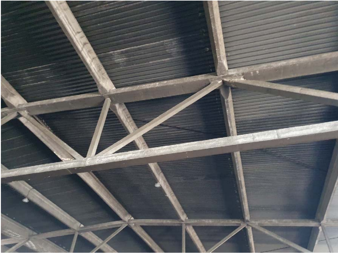
Fotografija 1: Rešetka u osovini 10 – oštećenje dijagonale
